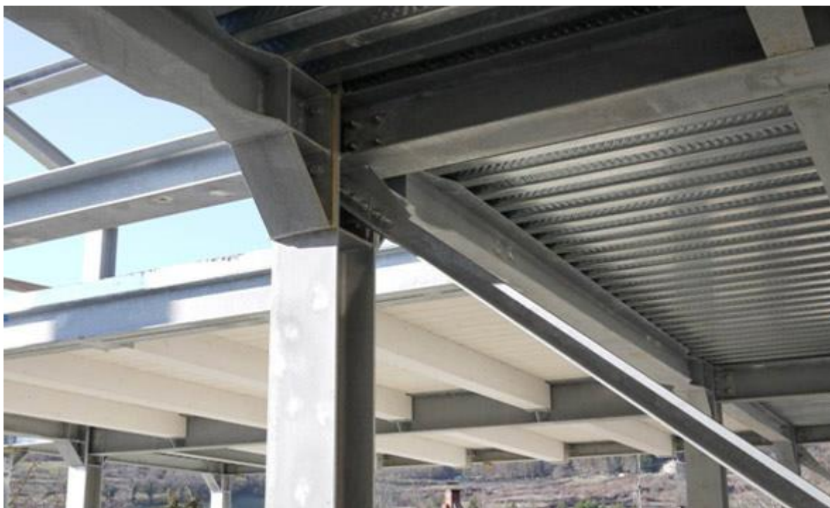
Strutture in fase di cantiere per la WISEHOUSE realizzata a Stia (AR) © Edilizia Integrale spa
